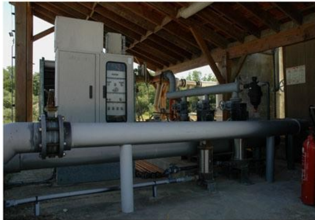
Figure 42 – Photographie de l'installation géothermique de la ferme piscicole du Teich
